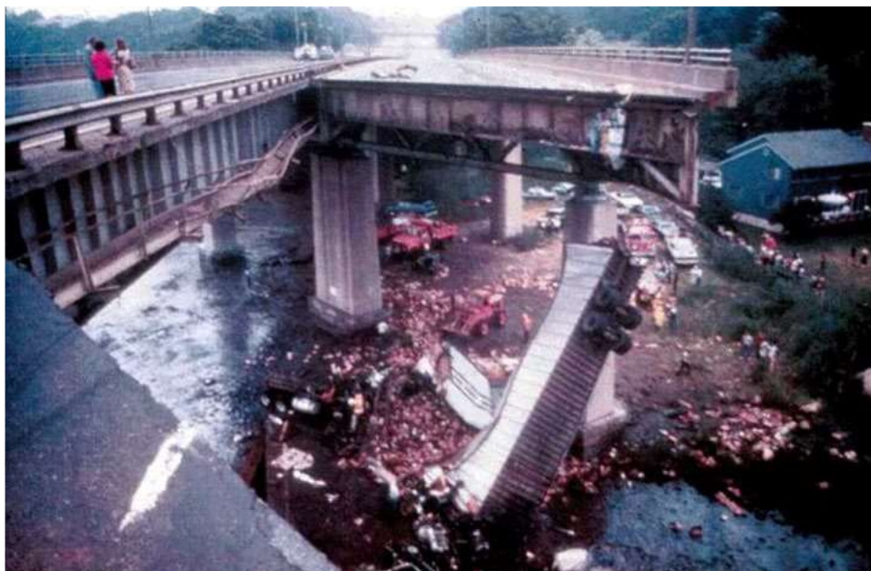
Рисунок 3 – Разрушение моста Мианус
