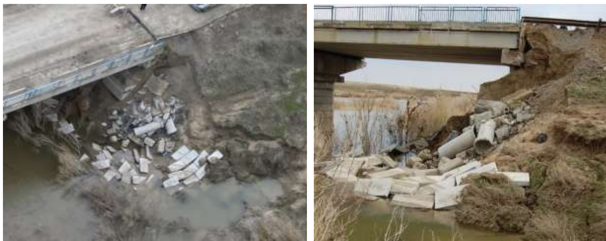
Рисунок 1 – Разрушение конуса насыпи вокруг опоры № 1 с верховой стороны
