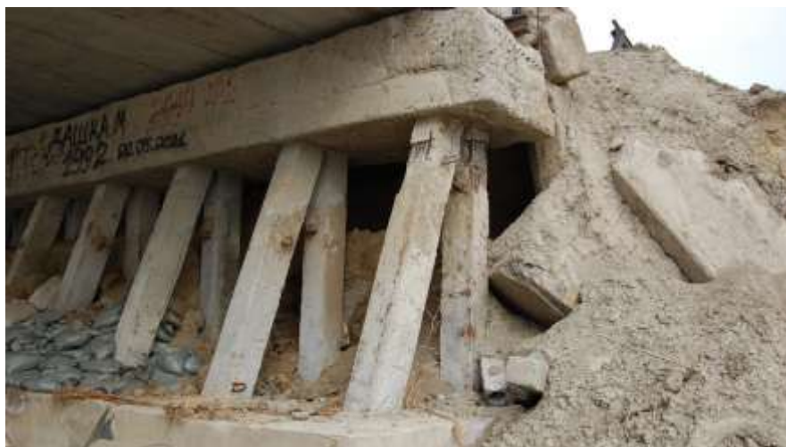
Рисунок 2 – Размыв грунта вокруг опоры № 6 с низовой стороны и образование пустот в теле насыпи
