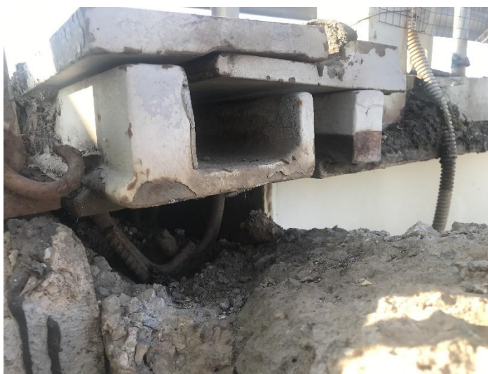
Рисунок 5 – Отрыв деформационного шва от бетона
