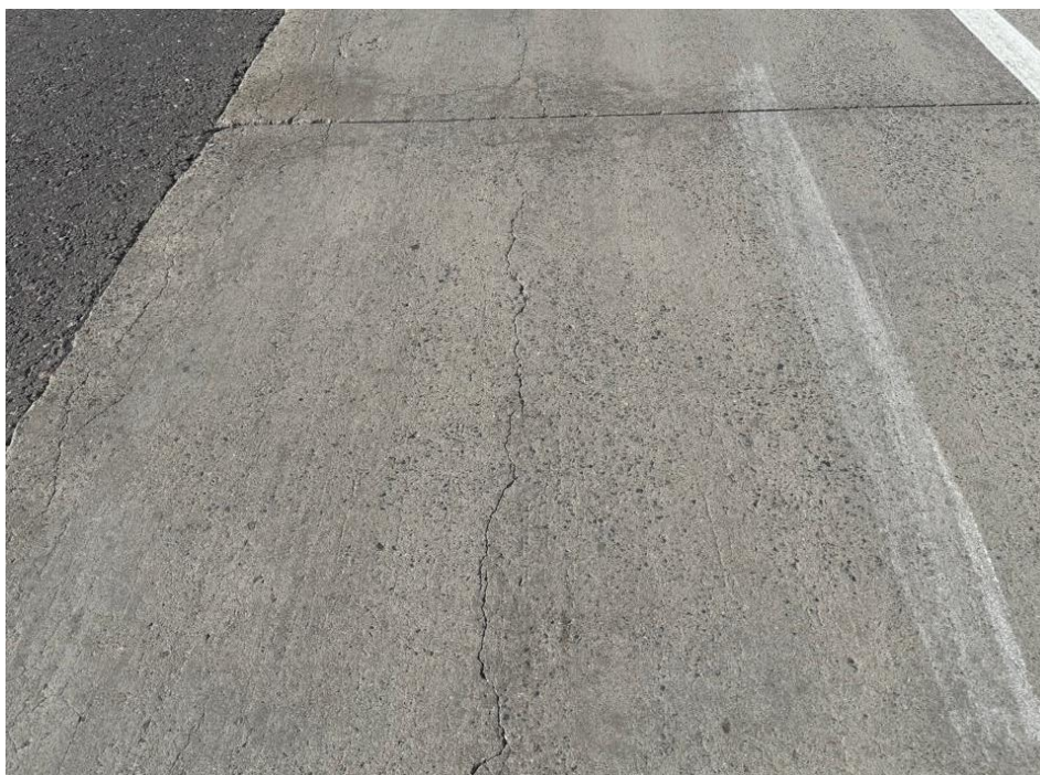
Рисунок 1 – Образование трещин на поверхности цементобетонного покрытия
