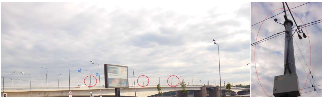
Рис. 5. ГНСС оборудование на мосту Александра Невского
